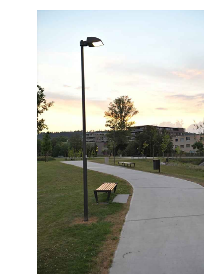
Kandelaber an Hauptweg (öffentliche Beleuchtung Stadt Winterthur)
